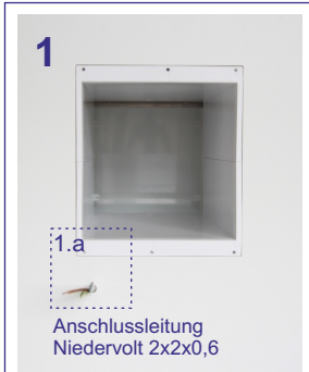
Wand-Teleskopeinheit und Netzanschluss sind vorbereitet
