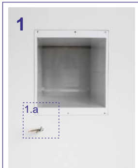
1 Wand-Teleskopeinheit und Netzanschluss sind vorbereitet
